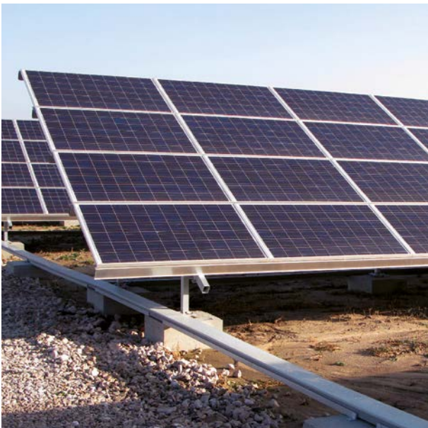
PV-array bedradingsgeleider, Spanje
