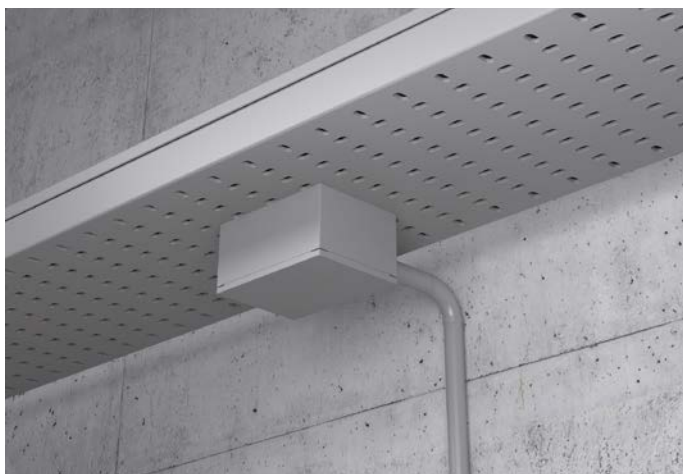
Caminhos de cabos isolantes 66
