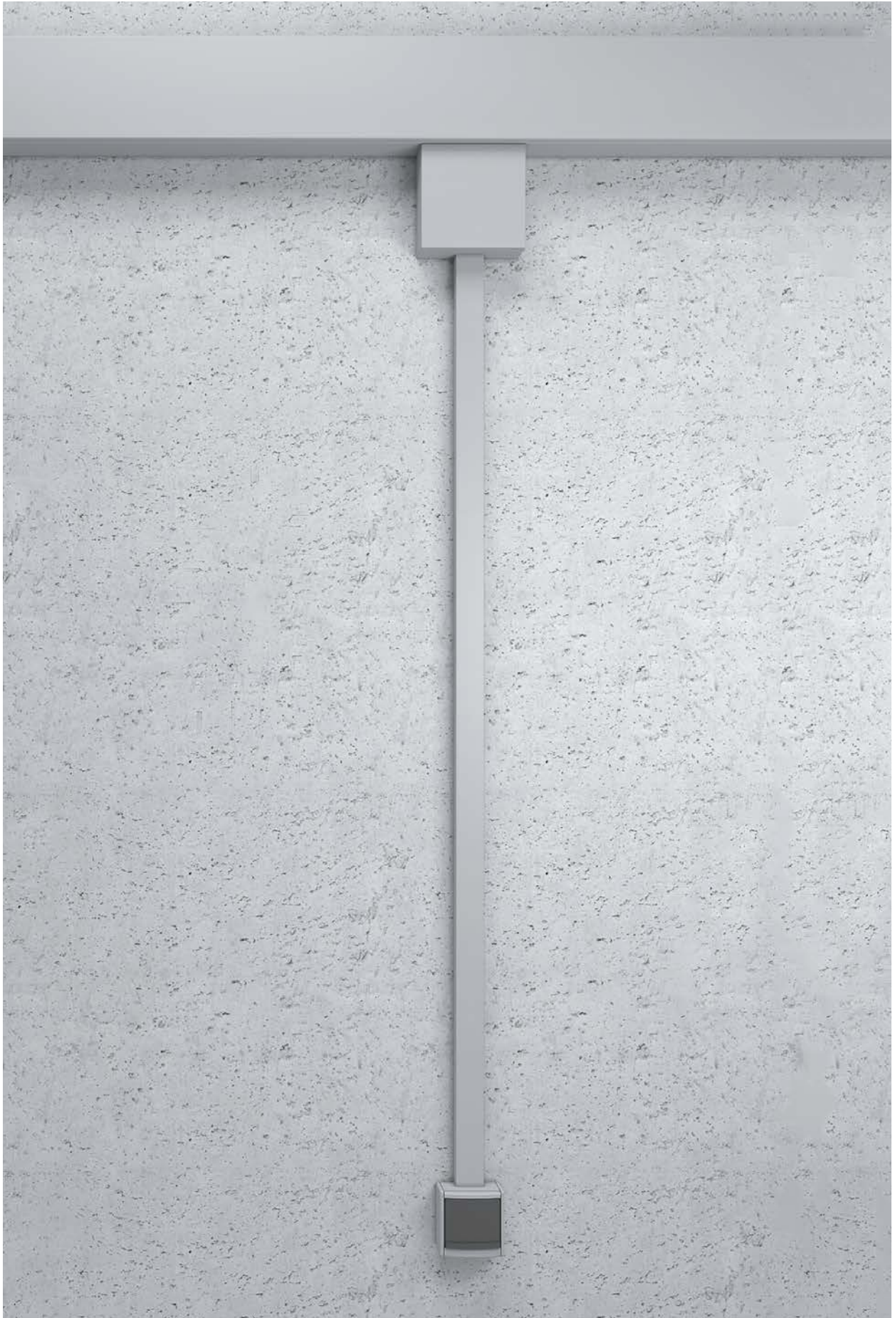
Nave industrial: alimentación de mecanismos
