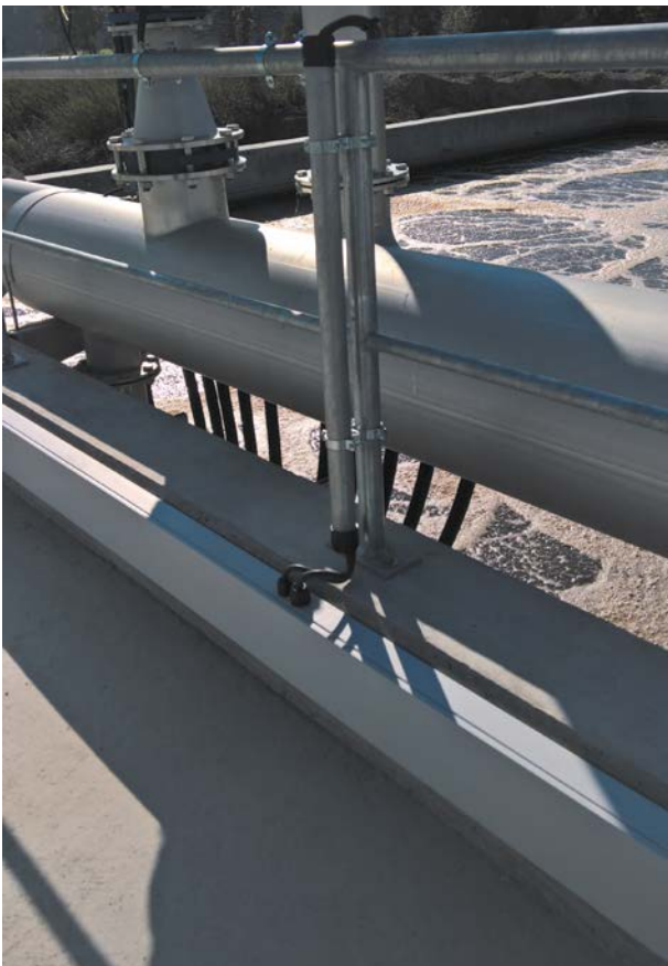
Tratamiento de aguas: EDAR
